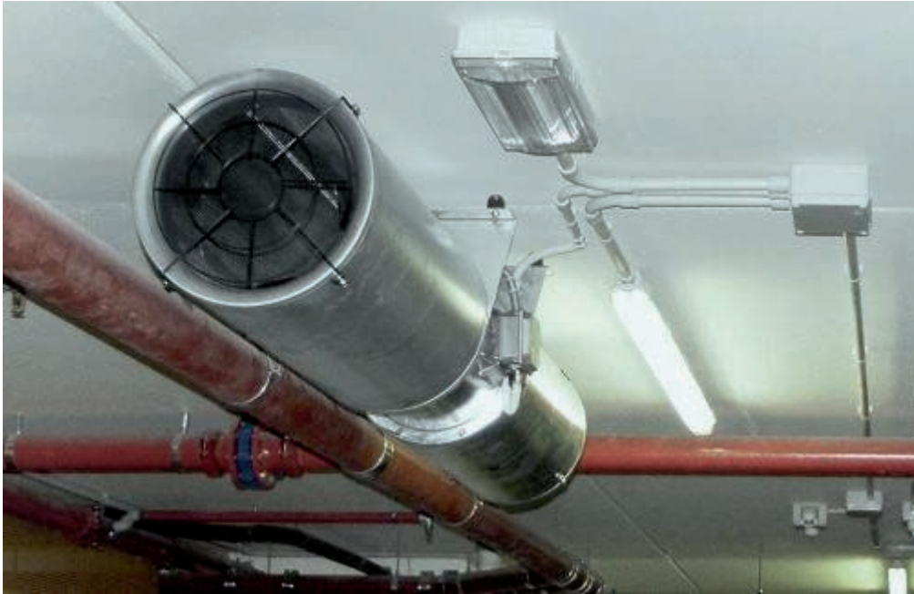
INSTALLAZIONE SISTEMA JET FANS
