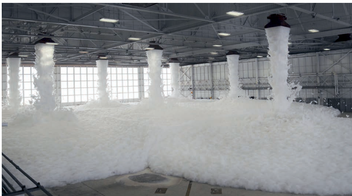
IMPIANTO DI SPEGNIMENTO A SCHIUMA IN FUNZIONE
