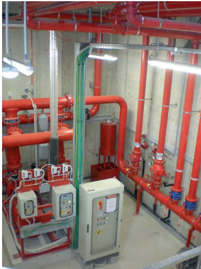
GRUPPO DI POMPAGGIO ANTINCENDIO
